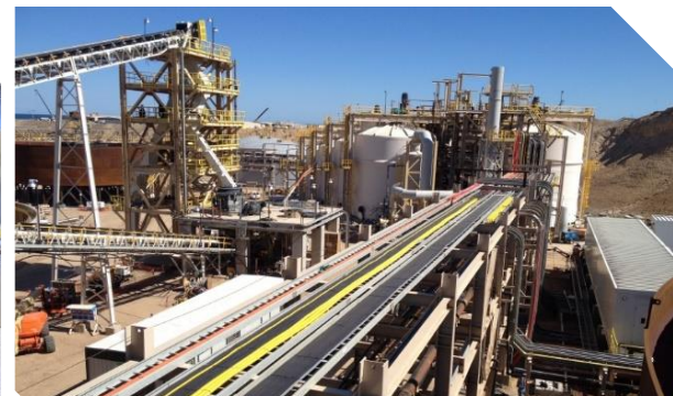
Cableado sobre racks
