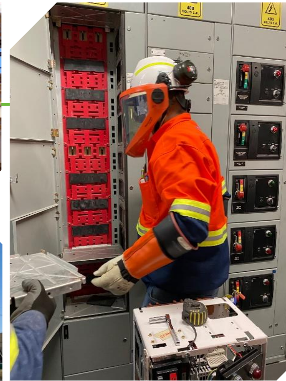
Instalación en cuartos de control
