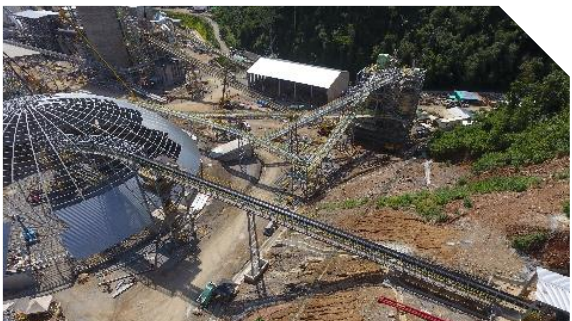
Banda transportadora y laminado de almacén circular
