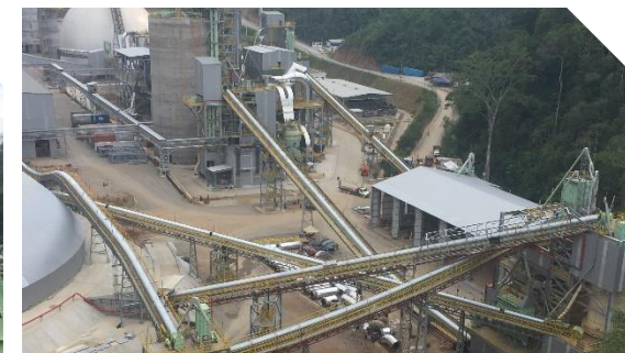
Bandas transportadoras y almacén circular
